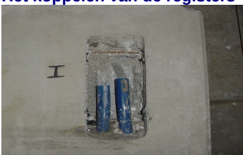
Koppeling aan de onderzijde van de Klimaatsvloer
