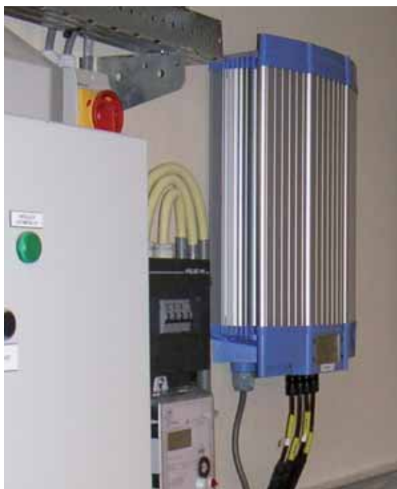
De omvormer zet de gelijkspanning om in 230 V wisselspanning.
